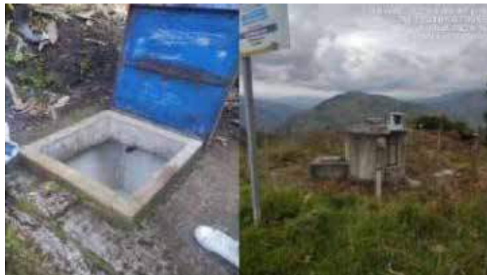
Figura 33. Captación de agua de la parroquia Cañi.
