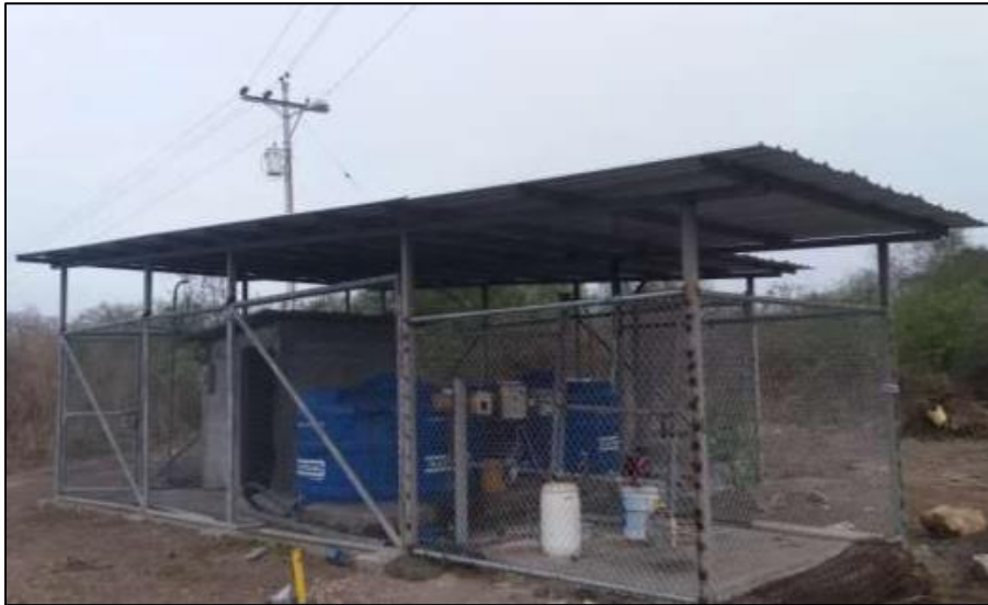
Fotografía. 1: Captación de agua en Estero de Boca
